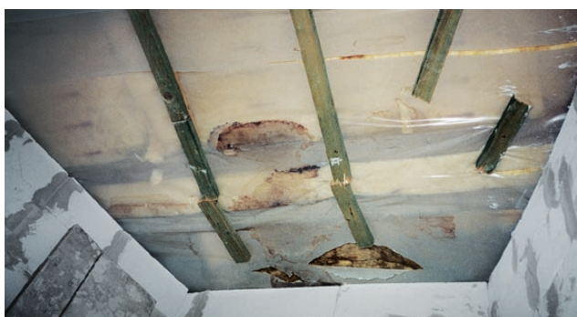
Poškození způsobené zkondenzovanou vodou
