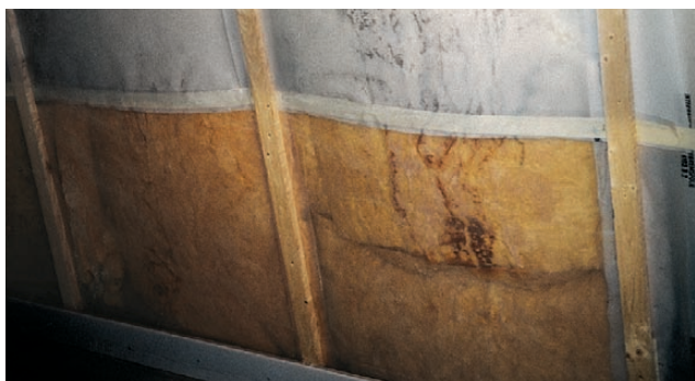
Poškození způsobené zabudováním vlhkého dřeva
